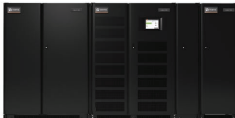
Combinação de gabinetes secundários permite instalação com cabeamento interno, gerando economias no custo de instalação e no espaço ocupado. Exibido: Gabinete de Bateria, 250kVA UPS, Gabinete de Bypass de Manutenção
